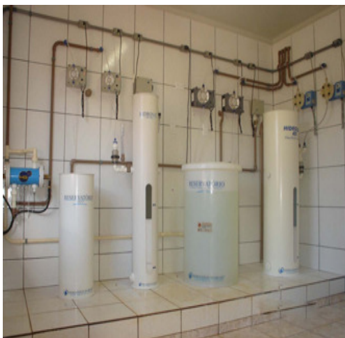
Figura 1. Equipamento de cloração da água de abastecimento industrial, Hidrogerox.
